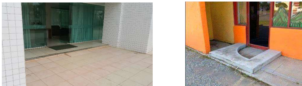
Figura 8 – Deficiência de desníveis entre áreas internas e externas.
