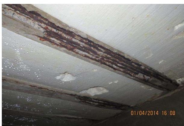
Figura 10 - Concepção inadequada para estrutura em teto interno de reservatório - acervo do autor.
