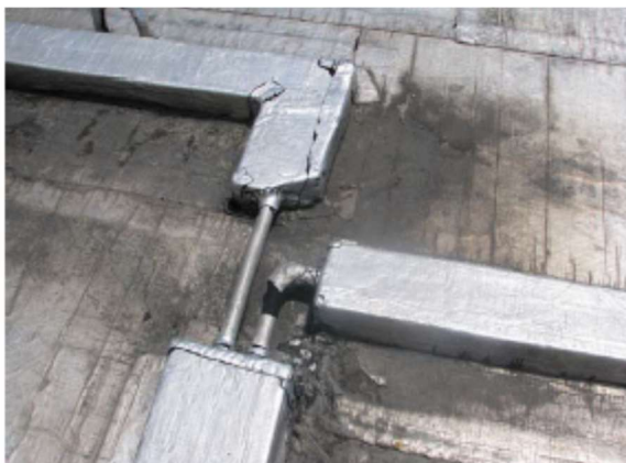
Figura 5 - Tubulações inadequadamente sob impermeabilização - acervo do autor.
