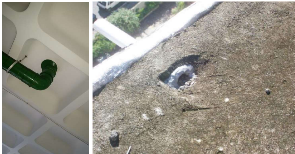
Figura 3 - Drenagem comprometida pela não previsão de arremate impermeabilizante - acervo do autor.
