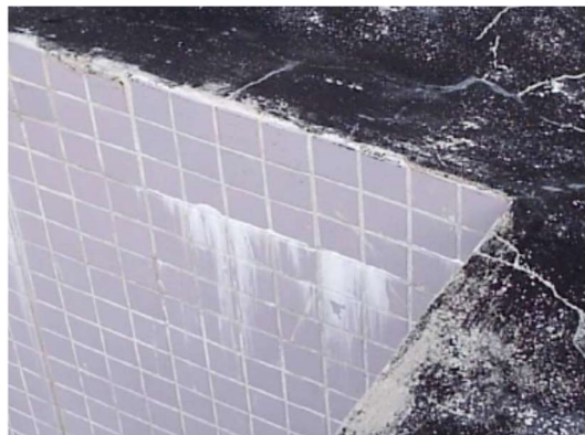
Figura 9 - Ausência de contenção perimetral em lajes, gerando eflorescências.
