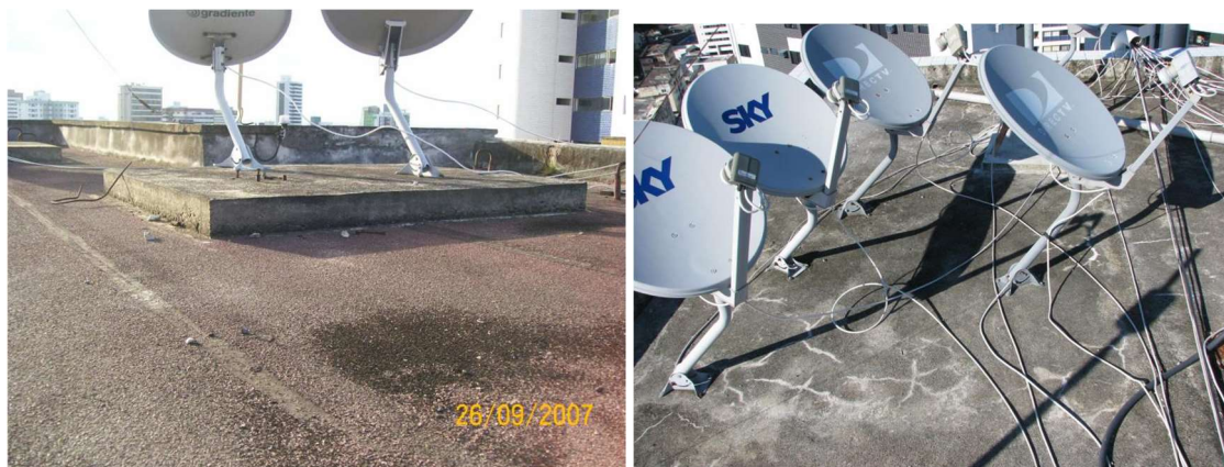
Figura 7 - Antena fixada inadequadamente perfurando sistema impermeabilizante - acervo do autor.
