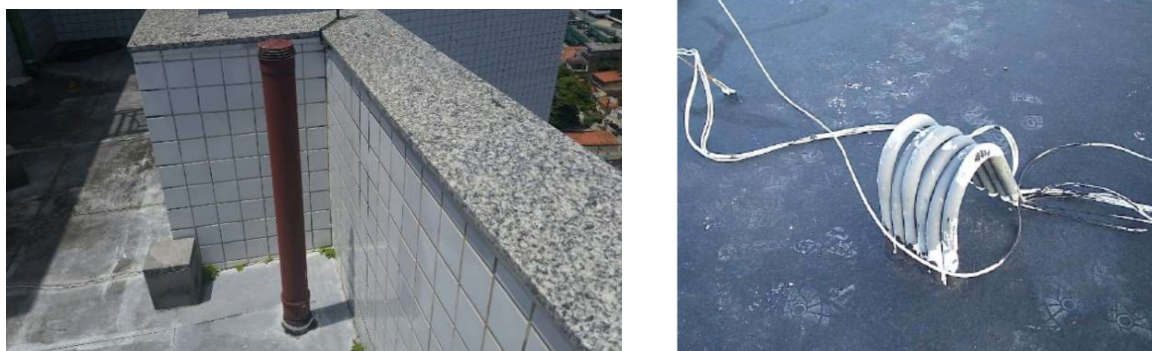
Figura 4 - Instalações elétricas sem espaçamento entre faces verticais - acervo do autor.
