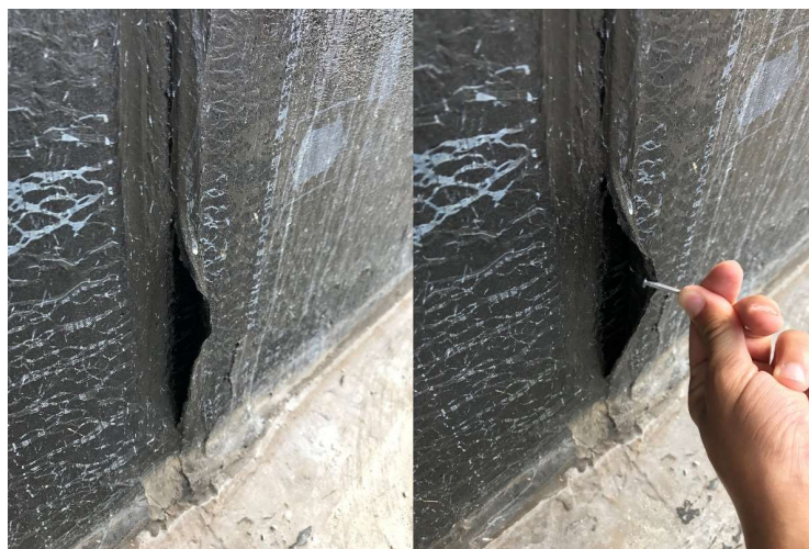
Figura 18: Falha de execução na emenda entre mantas (I1)
