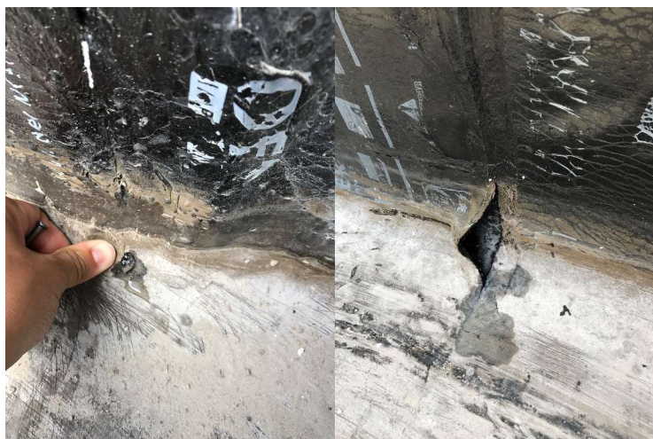
Figura 21: Falha de execução na emenda da manta (I4)
