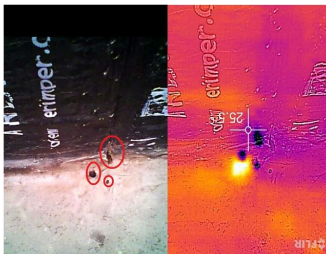
Figura 17: Infiltração em local danificado (I2)
