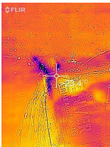
Figura 19: Infiltração emenda rodapé (I2)
