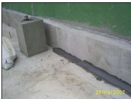
Figura 7.3 – Solução adequada executada na obra. Cantos arredondados adequadamente, de acordo com a necessidade do tipo de impermeabilização que será aplicada no local.
