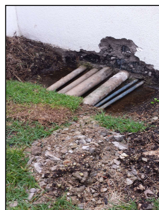
Figura 12.2 – Tubos perfurando a impermeabilização.
