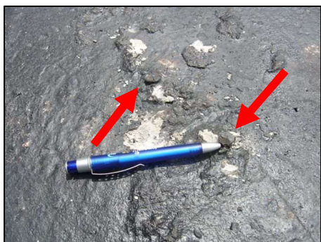
Figura 10.1 – Situação desfavorável executada na obra.
