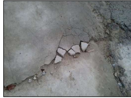
Figura 6.4 – Situação desfavorável executada na obra. Regularização da superfície e caimento efetuado com argamassa de cimento e areia colocada posteriormente no local. Argamassa fraca, espessura menor que a ideal, sem aderência e desagregada).
