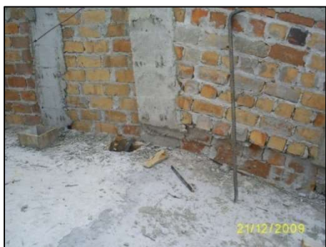
Figura 3.1 – Situação desfavorável executada na obra.
