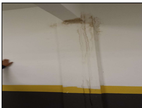
Figura 13.1 – Infiltrações sob área impermeabilizada.
