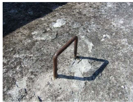
Figura 9.4 – Grampo com a base em contato direto com a "área alagada" do pavimento (piso final do pavimento = a própria proteção mecânica sobre a impermeabilização).
