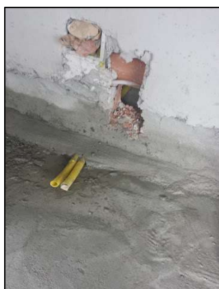
Figura 12.1 – Tubos perfurando a impermeabilização.
