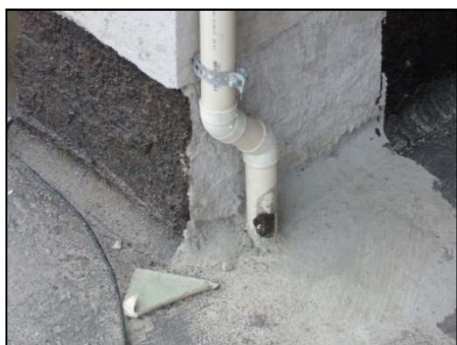
Figura 11.1 - Situação desfavorável executada na obra
