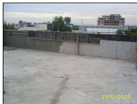
Figura 3.4 – Situação desfavorável executada na obra.
