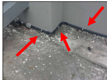
Figura 12.8 – Braçadeiras para a fixação de eletrodutos perfurando o rodapé onde a impermeabilização está ancorada.
