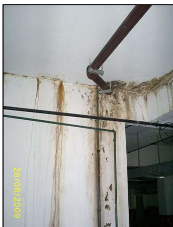
Figura 13.3 – Infiltrações sob área impermeabilizada.
