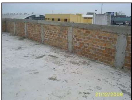
Figura 3.3 – Situação desfavorável executada na obra.
