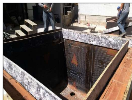
Figura 4.2 – Situação desfavorável executada na obra. Paredes da floreira com a impermeabilização já aplicada e faltando a execução da cinta de coroamento em concreto.
