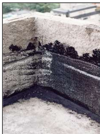
Figura 3.8 – Resultado da solução adequada executada na obra para a platibanda da Figura 2.7. Platibanda com a ancoragem da impermeabilização efetuada no rebaixo para essa finalidade.
