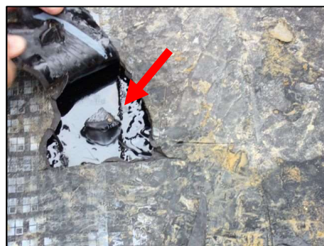
Figura 10.6 - Situação desfavorável executada na obra
