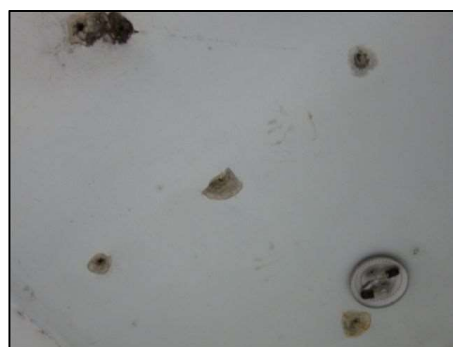
Figura 9.6 – Infiltrações na laje abaixo dos grampos mostrados na Figura 9.5.
