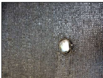
Figura 8.7 – Resultado da verificação do não preenchimento do furo para a passagem das agulhas. Ficou uma descontinuidade na membrana asfáltica.
