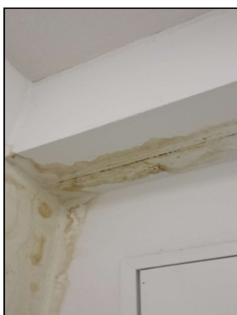
Figura 13.5 – Infiltrações sob área impermeabilizada.
