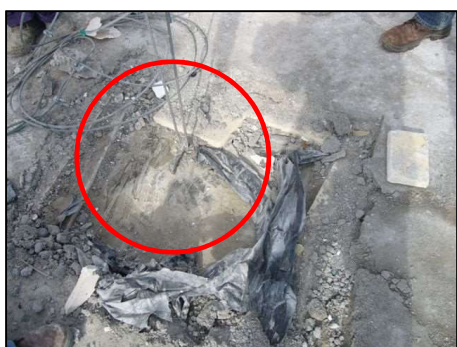
Figura 9.3 – Grampo saliente em local já impermeabilizado, com camada separadora, isolamento térmico e com proteção mecânica parcialmente executados.
