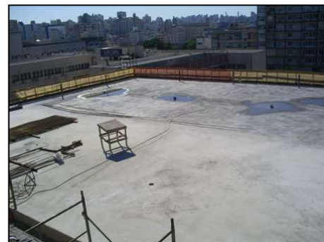
Figura 6.2 – Solução adequada executada na obra. Caimento em direção aos ralos efetuado no próprio concreto durante a concretagem do pavimento.
