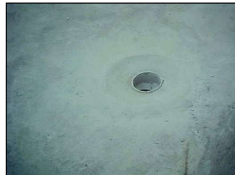
Figura 7.2 – Solução adequada executada na obra. Executado na argamassa de regularização da superfície.
