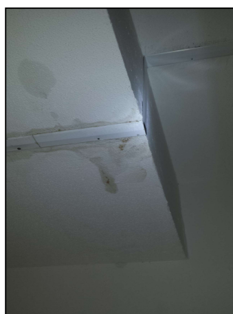
Figura 13.6 – Infiltrações sob área impermeabilizada.
