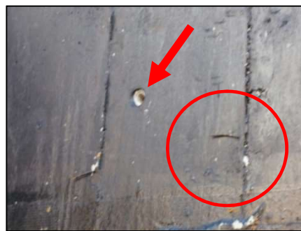
Figura 8.2 – Situação desfavorável executada na obra. Arame de travamento da forma saliente e ainda não cortado. Faltou tapar o furo para passagem das agulhas. Imprimação da superfície já está em andamento.
