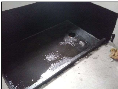
Figura 1.1 – Situação desfavorável executada na obra.
