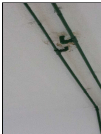
Figura 13.4 – Infiltrações junto às passagens das instalações em área impermeabilizada.
