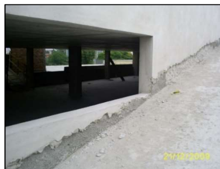
Figura 3.2 – Situação desfavorável executada na obra.
