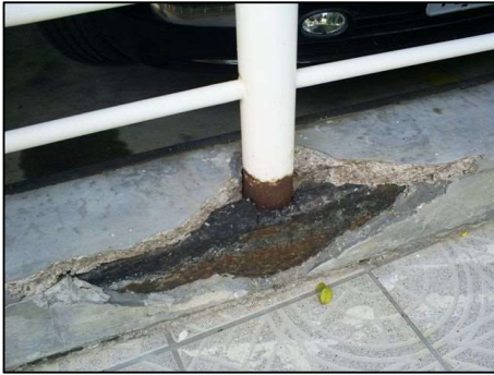
Figura 5.1 - Fixação do montante do guarda-corpo (antes da execução da impermeabilização) que não permite uma ancoragem segura.
