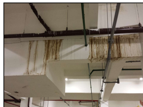
Figura 13.2 – Infiltrações sob área impermeabilizada.
