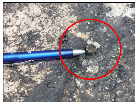
Figura 10.2 – Situação desfavorável executada na obra.
