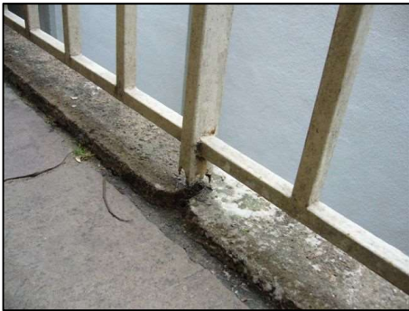
Figura 5.3 – Situação encontrada no local. Corrosão do montante do guarda-corpo, cuja correção afetará a impermeabilização.
