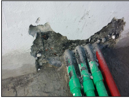
Figura 12.3 – Tubulações da rede de água atravessando a área impermeabilizada.
