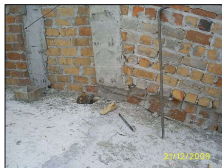
Figura 11.2 - Situação desfavorável executada na obra
