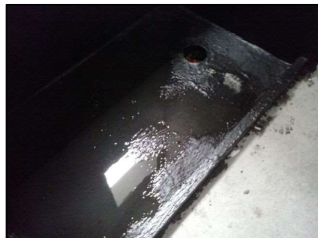
Figura 1.2 – Situação desfavorável executada na obra.
