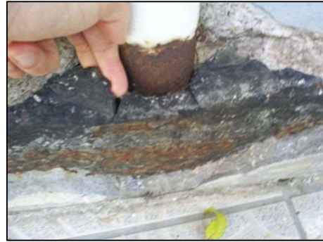
Figura 5.2 – Corrosão do montante do guarda-corpo, envelhecimento e descolamento da impermeabilização e entrada de água entre os materiais.
