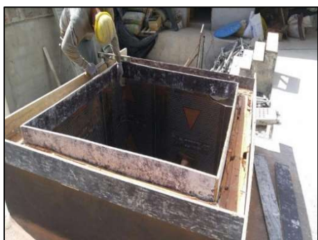
Figura 4.1 – Situação desfavorável executada na obra. Paredes da floreira com a impermeabilização já aplicada e faltando a execução da cinta de coroamento em concreto.
