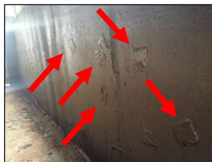
Figura 8.8 – Situação desfavorável executada na obra. “Reforço” feito com manta asfáltica sobre os vazios das imagens acima, mostradas nas Figuras 8.1 a 8.7
