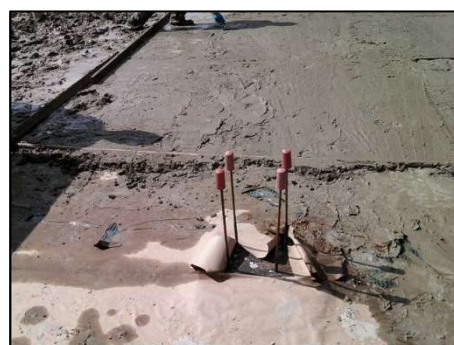
Figura 10.4 – Situação desfavorável executada na obra.
