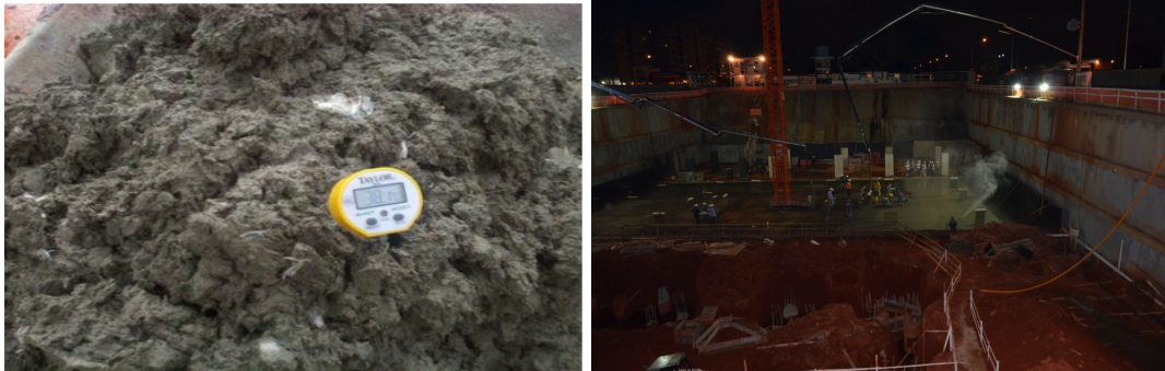
Figura 6 – (a) Medição da temperatura do concreto nos caminhões, a partir de um termômetro digital de vareta; (b) Concretagem sempre com duas bombas
