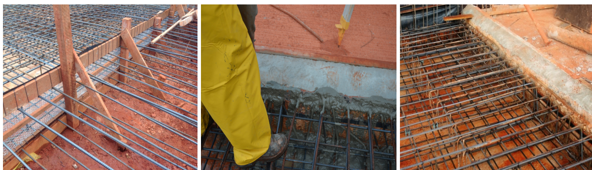
Figura 8 – (a) Detalhe da tela galvanizada ao longo da futura junta de concretagem; (b) Detalhe da pintura com primer na interface da junta; (c) Detalhe da fita hidroexpansiva flexível instalada na interface da junta
