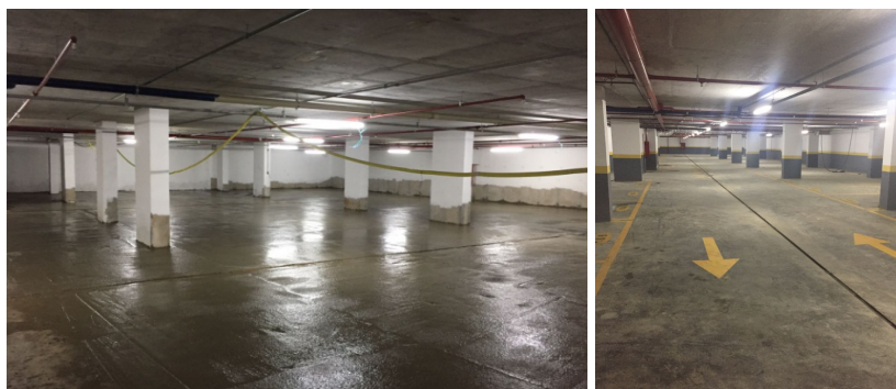
Figura 12 – (a) Execução de concreto polido sobre a laje de subpressão; (b) Vista final do piso acabado após demarcações de garagem
