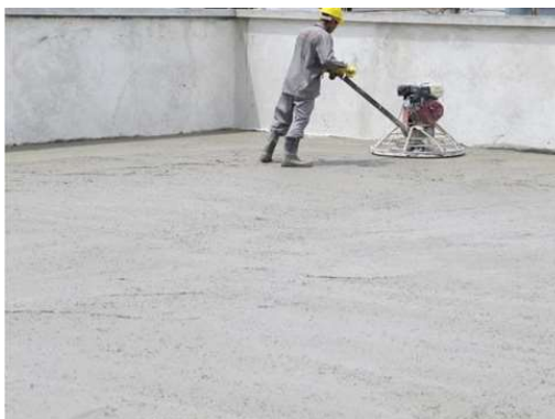
Figura 8 – Proteção mecânica armada
