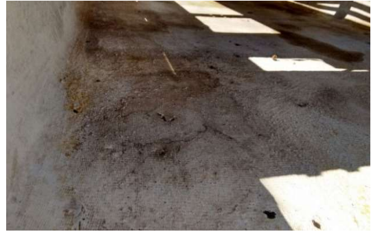
FIGURA 17- Manchas de contaminação de resíduos (óleos). (Fonte: a autora, 2017)
