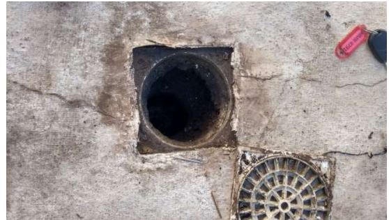
FIGURA 19- Irregularidade na impermeabilização dos ralos. (Fonte: a autora, 2017)
