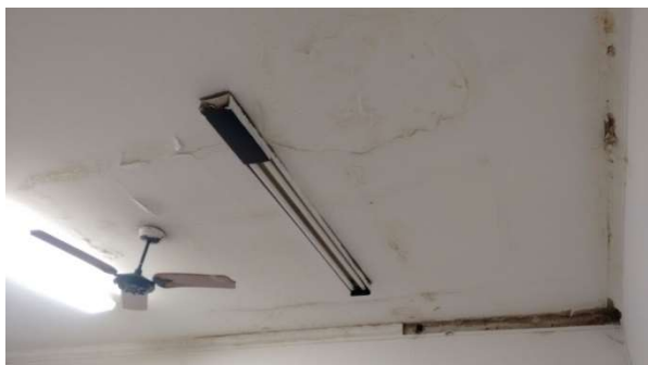
Figura 7- Degradação do forro e acabamento. (Fonte: a autora, 2017)
