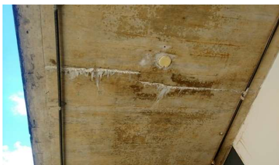
Figura 05- Formação de estalactites em laje em balcão. (Fonte: a autora, 2017)
