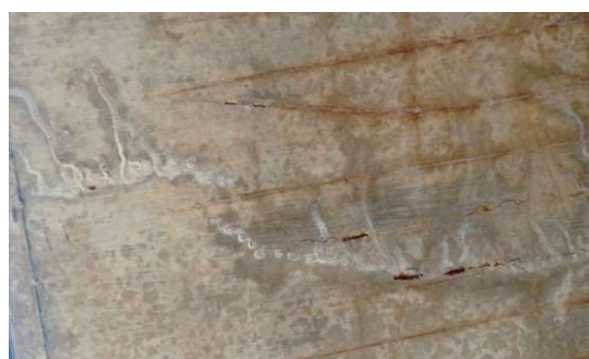
Figura 06- Manchas na cor branca, deslocamento de concreto e exposição da armadura oxidada. (Fonte: a autora, 2017)
