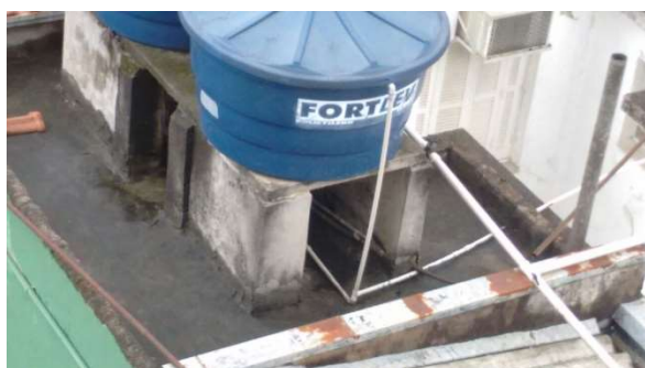
Figura 9- Laje sem impermeabilização e ralos obstruídos. (Fonte: a autora, 2017)
