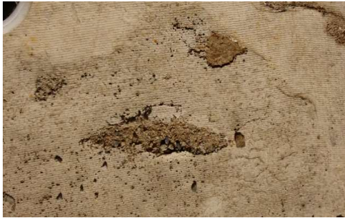
FIGURA 18- Deslocamento da camada de impermeabilização. (Fonte: a autora, 2017)
