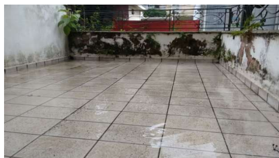
Figura 12- Laje revestida com cerâmica, sem impermeabilização. (Fonte: a autora 2017)
