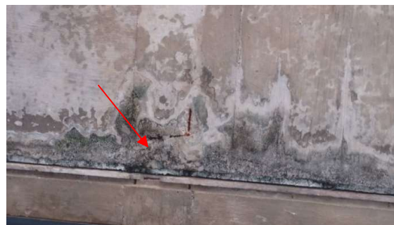
Figura 2- Junta de dilatação com manchas, mofo e armadura exposta oxidada. (Fonte: a autora, 2017)
