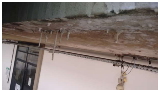
Figura 04- Formação de estalactite em laje de concreto armado próximo a platibanda (Fonte: a autora, 2017)
