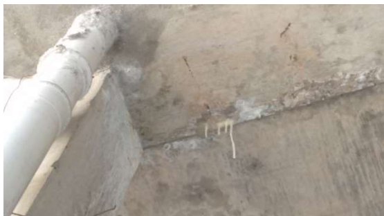
Figura 03- Formação de estalactite em laje de concreto armado. (Fonte: a autora, 2017)
