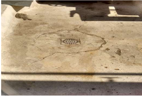
FIGURA 16- Fissuras no perímetro dos ralos. (Fonte: a autora, 2017)
