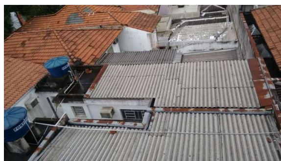
Figura 10- Lajes com telhados e rufos desgastados. (Fonte: a autora, 2017)
