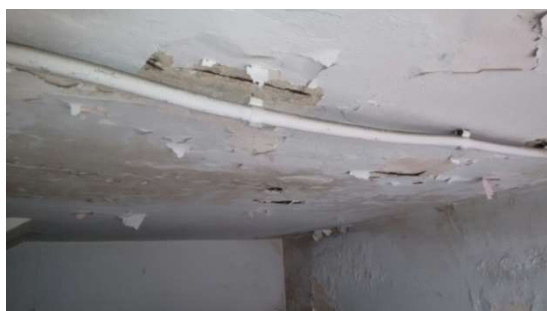
Figura 11- Laje e paredes com destacamento de revestimento e corrosão de armaduras. (Fonte: a autora 2017)
