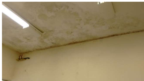
Figura 8- Manchas amarelas decorrentes da umidade no forro. (Fonte: a autora, 2017)
